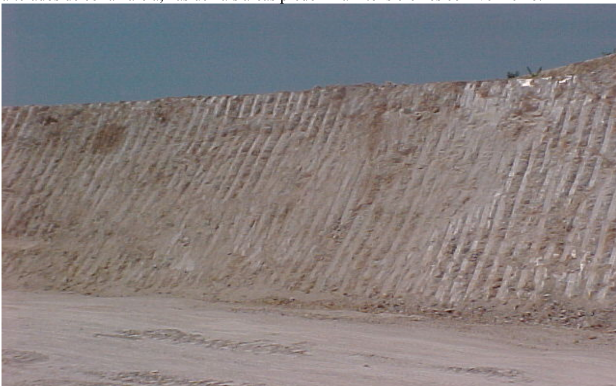
Figura II.7 – Vista do talude intermediário, exibindo um manto de alteração predominantemente na cor creme claro. Esse padrão se repete no talude superior.
